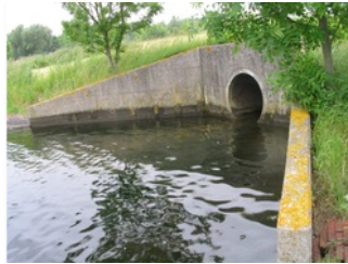
Einleitung in Hafenbecken
